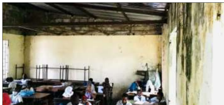
L'école a bien besoin de gros travaux.
